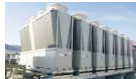
▲導入を進めている電気式空調設備
