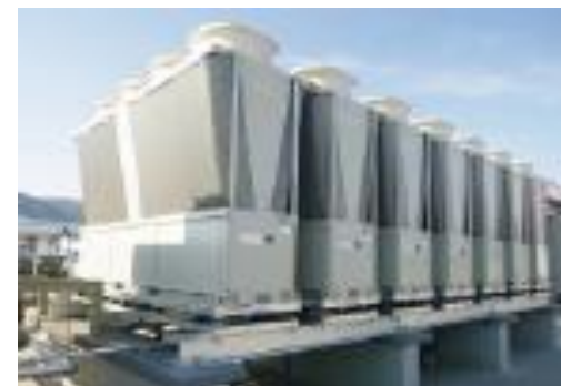
現在導入を進めている電気式空調設備
