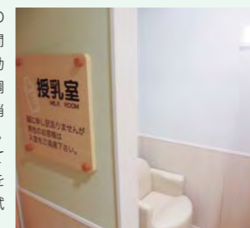
授乳室に設置した有機EL照明
