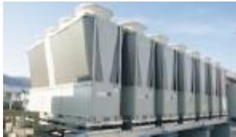
▲導入を進めている電気式空調設備
